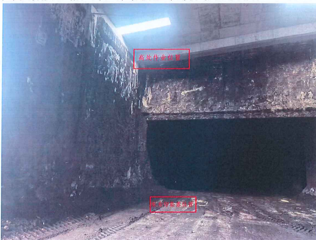
图 3 事故现场照片
